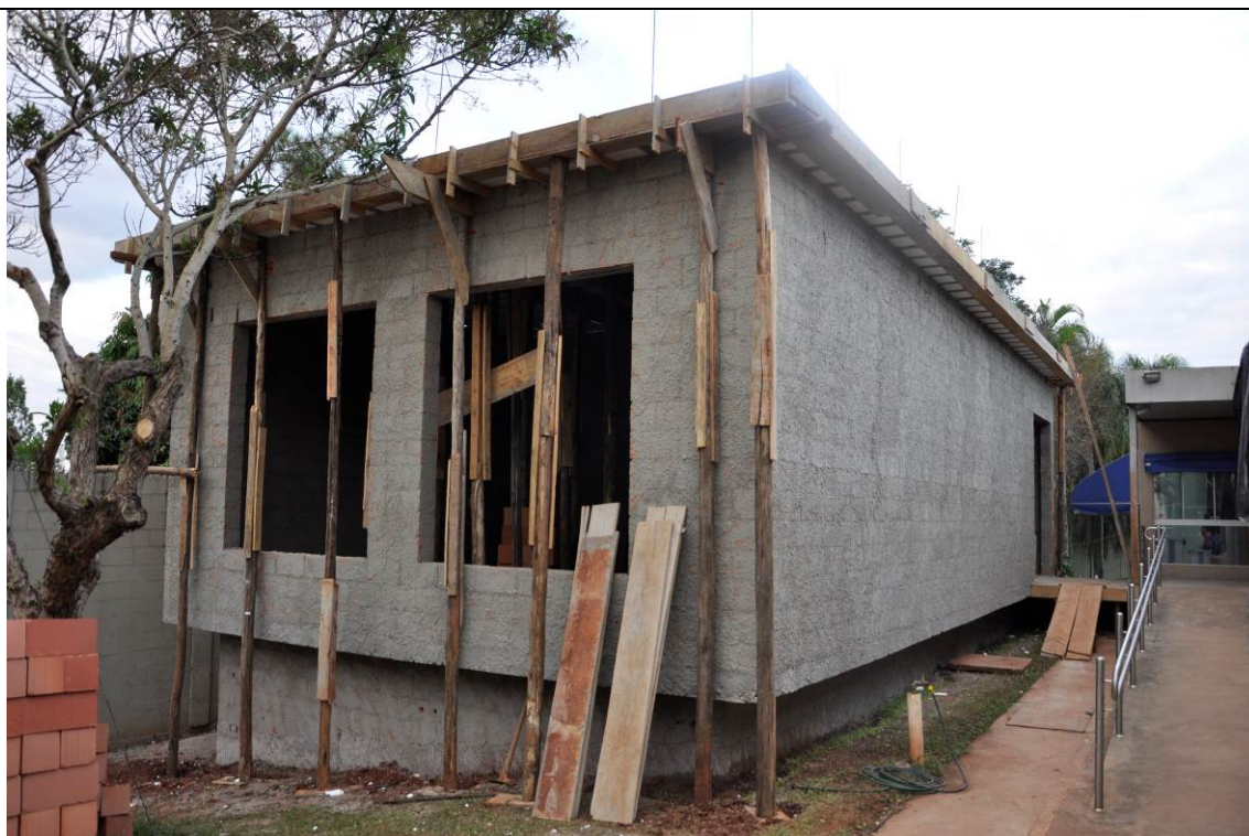
07/07/2017 – Vista geral da obra. Laje de forro concretada. Detalhe dos arranques da alvenaria da platibanda.
