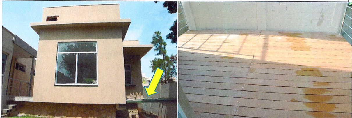
Reparo das trincas no piso de granilite no acesso ao refeitório e substituição da soleira de granito da porta de correr que está trincada
