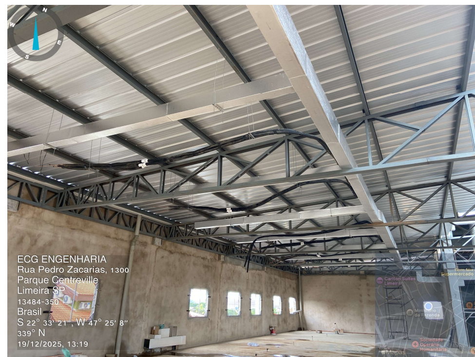
Infra para Alimentação do Sistema de Ar-Condicionado – Prédio Ampliação.
